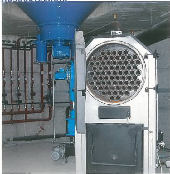
Siloaustragung mit Kesselanlage
