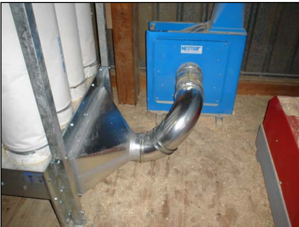
Transportventilator zur Beförderung der Späne in die Brikettierpresse.
