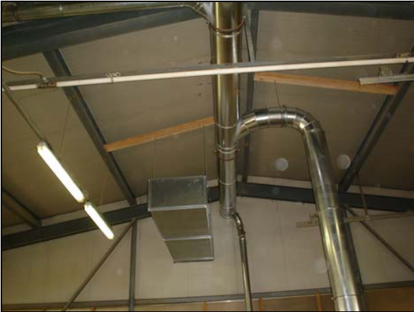
Rückluftkanal aus Lochbelch mit angeflanschter Brandschutzklappe inkl. Endschalter.
