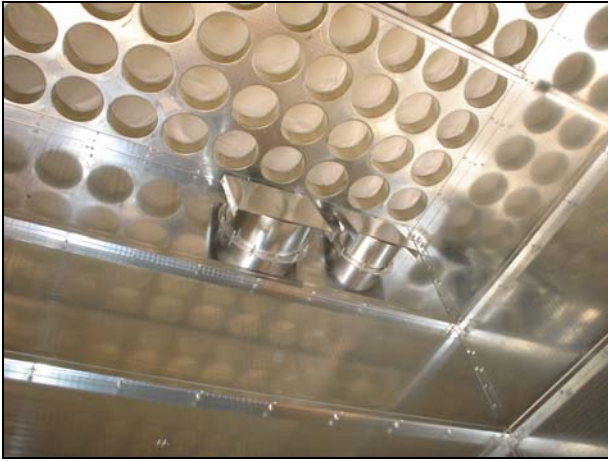
Rückstauklappen der 2 Ventilatoren im Rohluftbereich.
