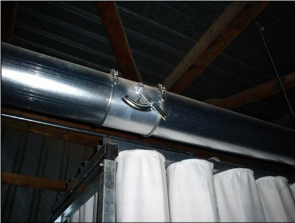
Drosselklappe zur Regulierung der Ringtransportanlage.
