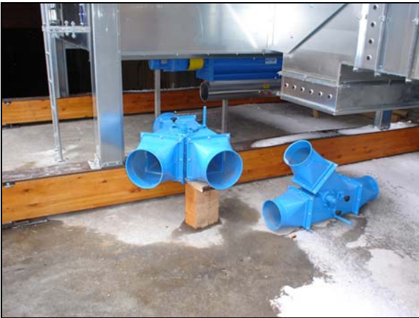
Umschaltweichen zur Wahlweisen Weiterleitung der abgesaugten Späne ins Silo oder in einen Container.
