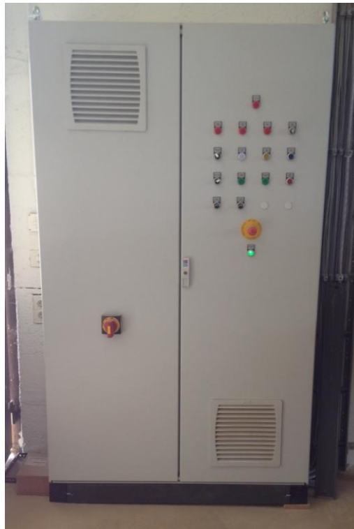
Schaltschrank NESTRO mit Frequenz-Umformer
